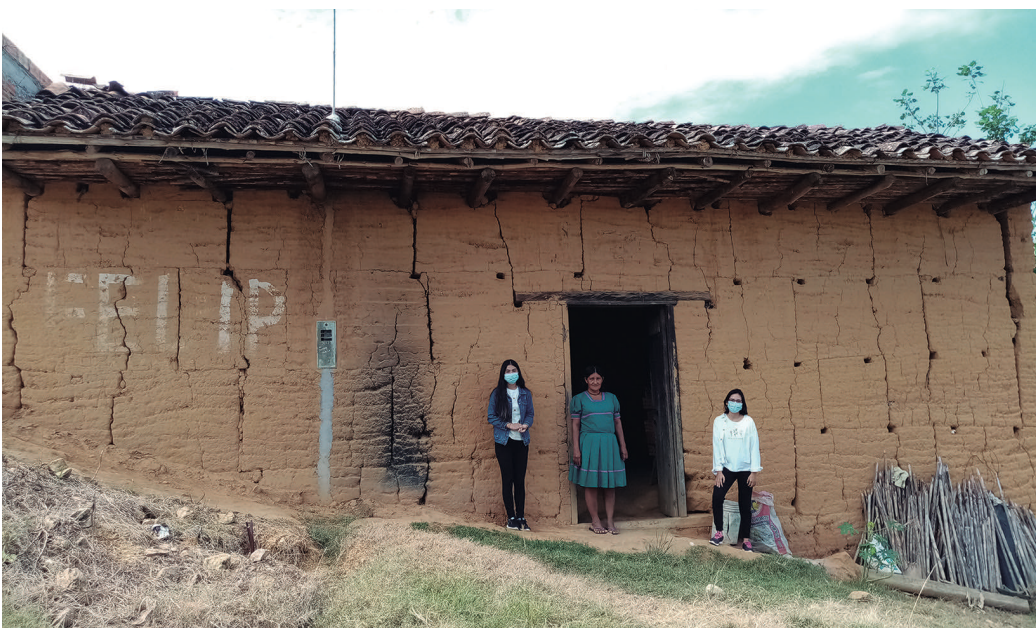
Vivienda típica del Barrio Wayku, con muros de tapial sin recubrimiento, de 3.00m o más de altura, construidos con módulos sobrepuestos, con ninguna o poca o ninguna trabazón, produciendo fisuras y grietas verticales, separaciones visibles y peligrosas.
